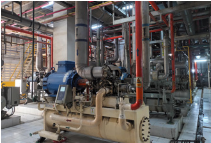
ระบบทำความเย็นด้วยสารแอมโมเนีย
